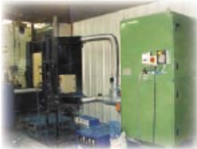
Filtres à décolmatage sur cabine de poudrage automatique
